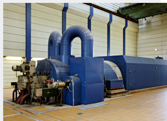
Randers Kraftvarmeværk blev indviet 14. oktober 1982 og erstattede byens gamle elværk på Mariagervej.
